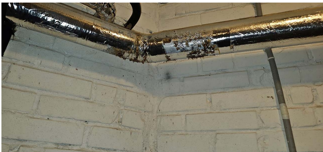
Фото 34 Повреждение теплоизоляции трубопровода.
