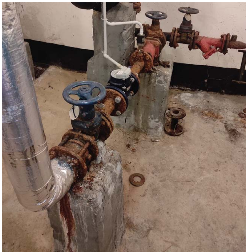
Фото 22 Значительная коррозия трубопроводов. Коррозия фланцевых соединений. Коррозия сварного соединения
