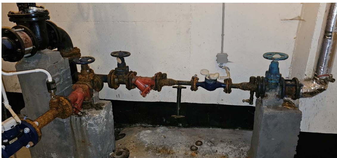
Фото 30 Значительная коррозия трубопроводов. Коррозия фланцевых соединений. Коррозия сварного соединения
