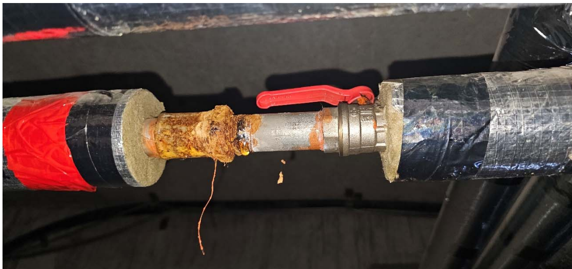
Фото 40 Коррозия резьбового соединения. Значительная коррозия трубопроводов.
