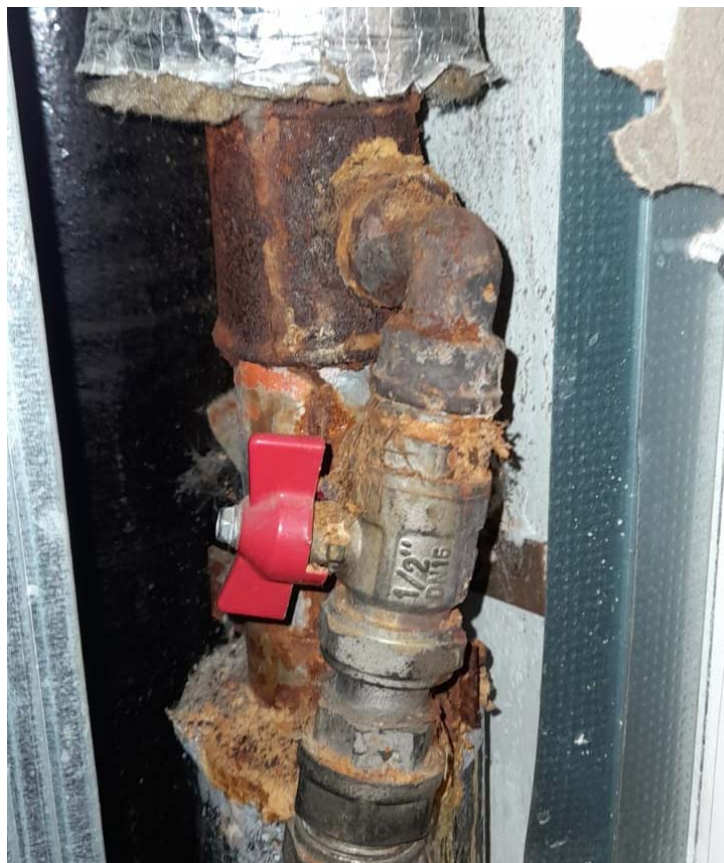
Фото 7 Значительная коррозия трубопроводов. Коррозия резьбового соединения. Коррозия сварного соединения Поражение коррозией отдельных участков трубопроводов
