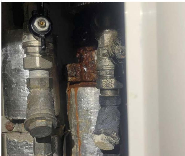
Фото 3 Капельные течи в местах врезки кранов. Коррозия резьбового соединения.
