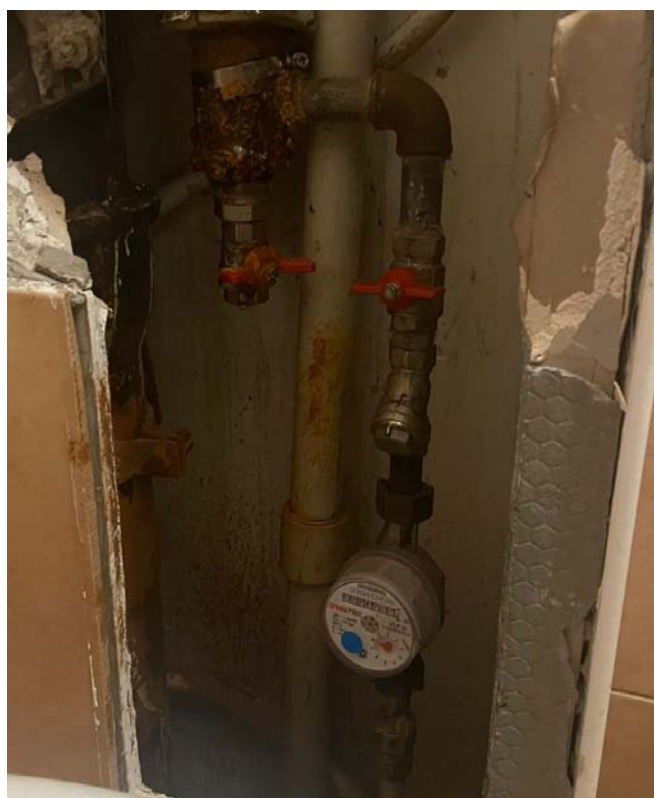
Фото 20 Значительная коррозия трубопроводов. Коррозия резьбового соединения. Коррозия сварного соединения
