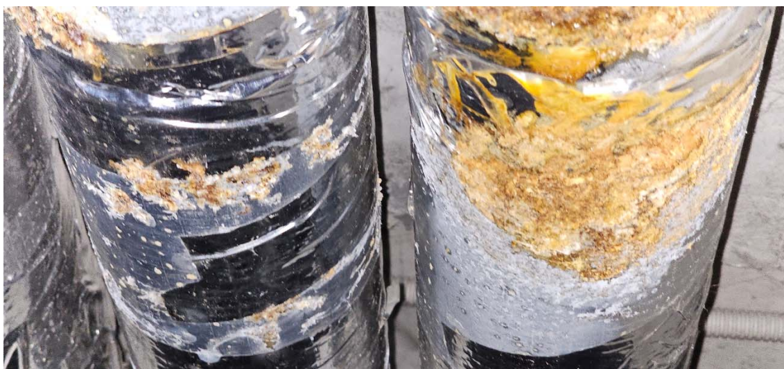
Фото 42 Повреждение теплоизоляции трубопровода.
