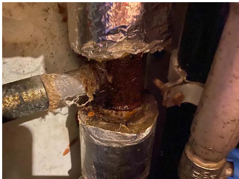
Фото 4 Значительная коррозия трубопроводов. Коррозия резьбового соединения.
