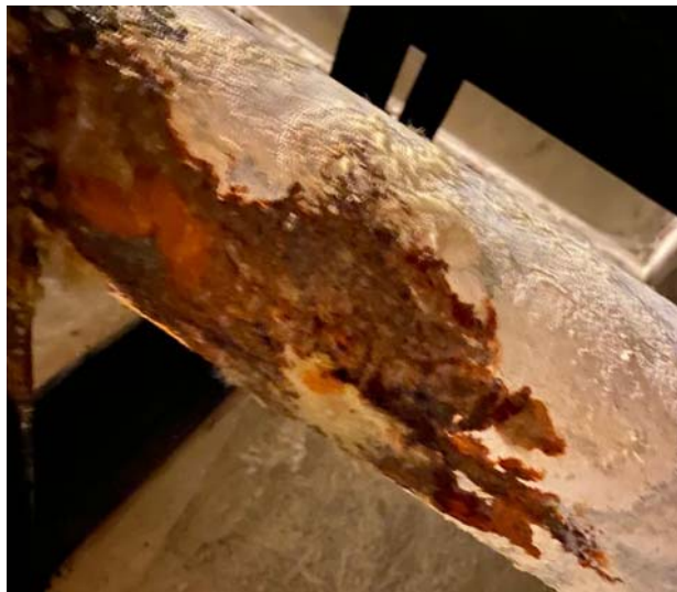
Фото 45 Значительная коррозия трубопроводов.
