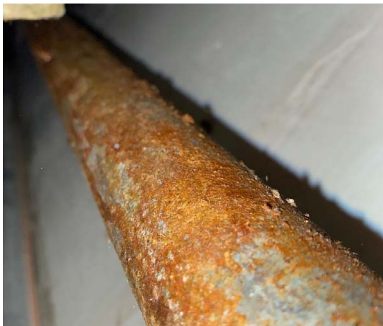
Фото 5 Значительная коррозия трубопроводов
