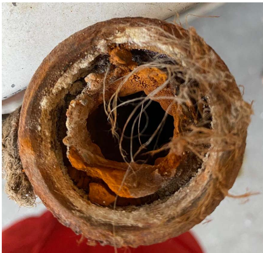
Фото 16 Ссужение внутреннего диаметра трубопровода.
