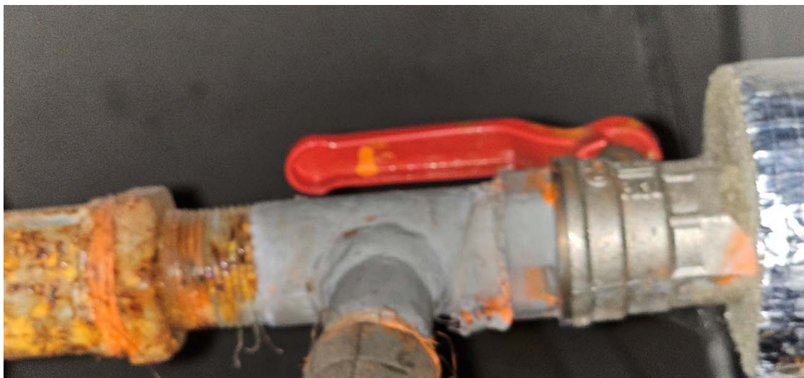
Фото 43 Коррозия резьбового соединения. Значительная коррозия трубопроводов.
