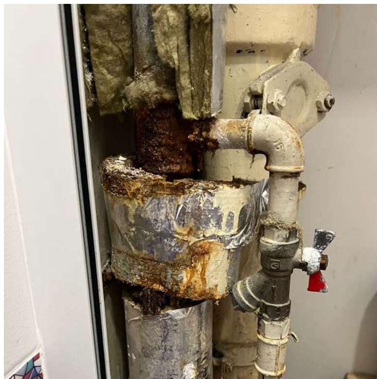
Фото 14 Значительная коррозия трубопроводов. Коррозия резьбового соединения. Коррозия сварного соединения Поражение коррозией отдельных участков трубопроводов
