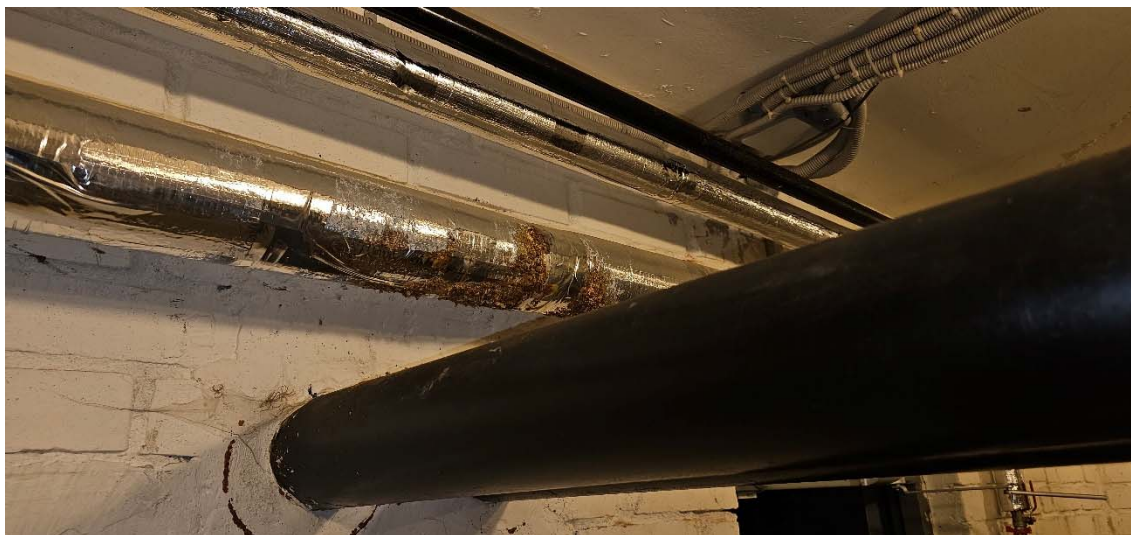
Фото 33 Повреждение теплоизоляции трубопровода.
