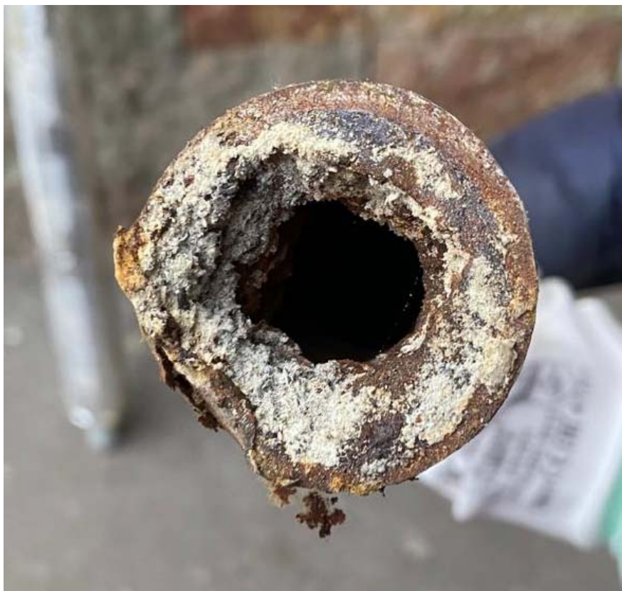
Фото 17 Ссужение внутреннего диаметра трубопровода.
