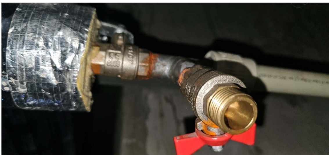
Фото 38 Коррозия резьбового соединения. Значительная коррозия трубопроводов.
