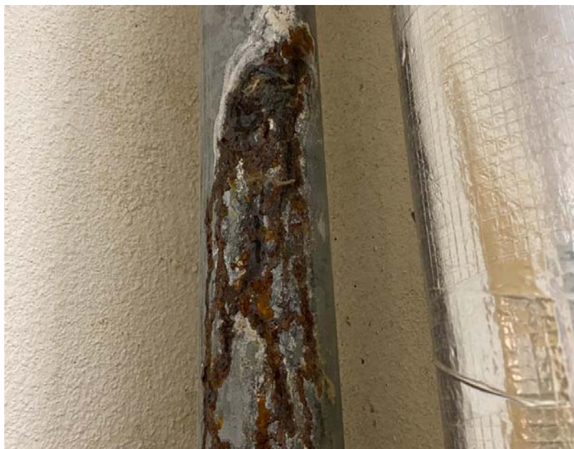
Фото 11 Значительная коррозия трубопроводов.
