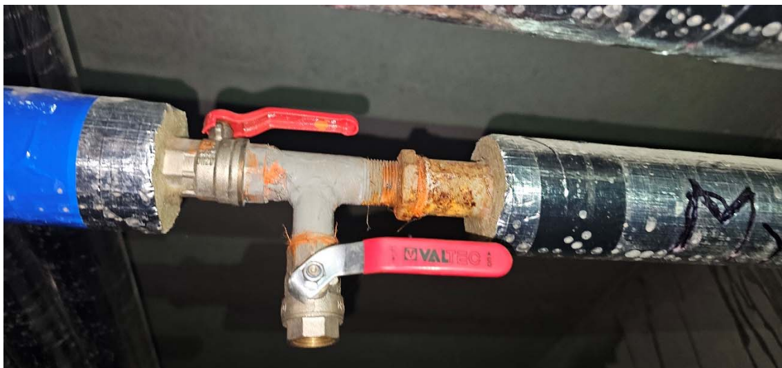
Фото 37 Коррозия резьбового соединения. Значительная коррозия трубопроводов.
