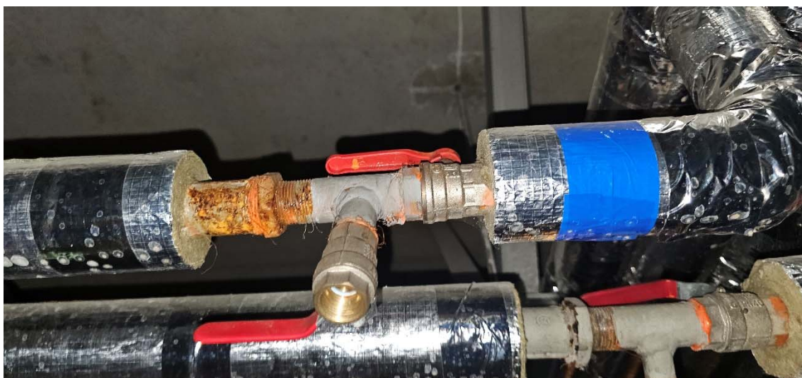
Фото 44 Коррозия резьбового соединения. Значительная коррозия трубопроводов.
