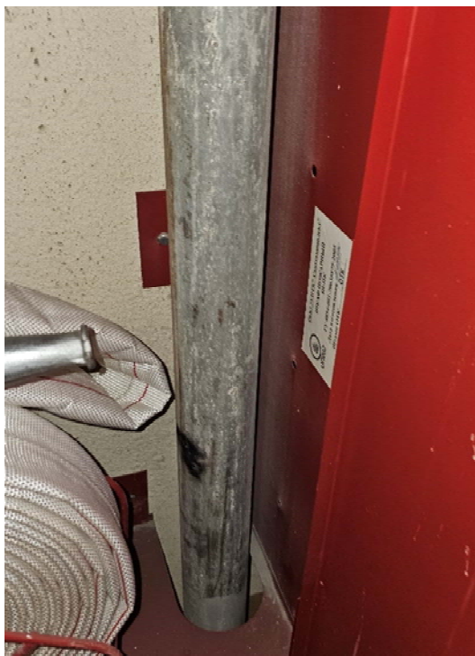
Фото 27 Поражение коррозией отдельных участков трубопроводов
