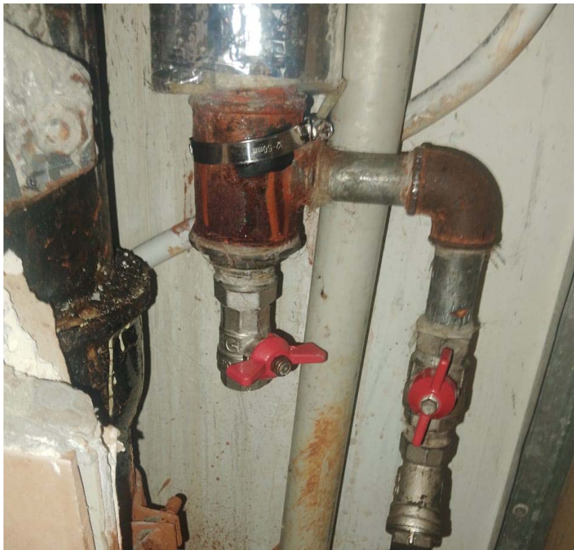
Фото 15 Коррозия резьбового соединения. Коррозия сварного соединения Значительная коррозия трубопроводов.
