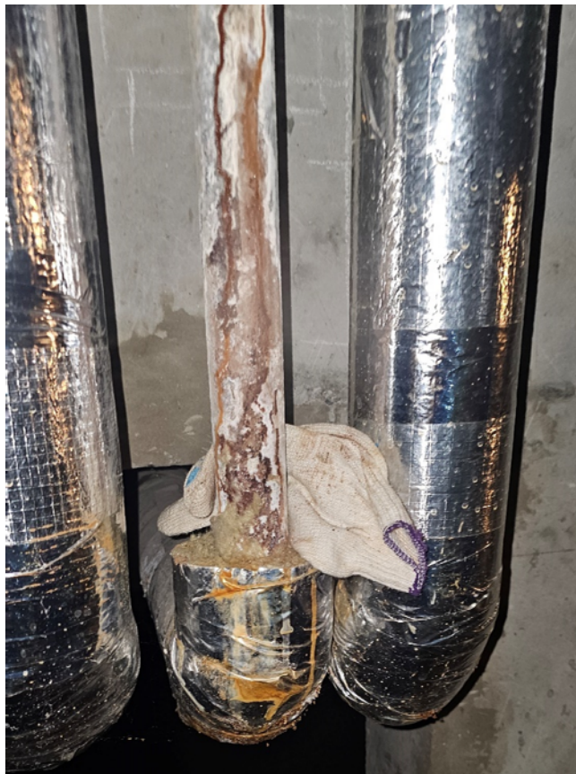
Фото 39 Значительная коррозия трубопроводов. Повреждение теплоизоляции трубопровода.
