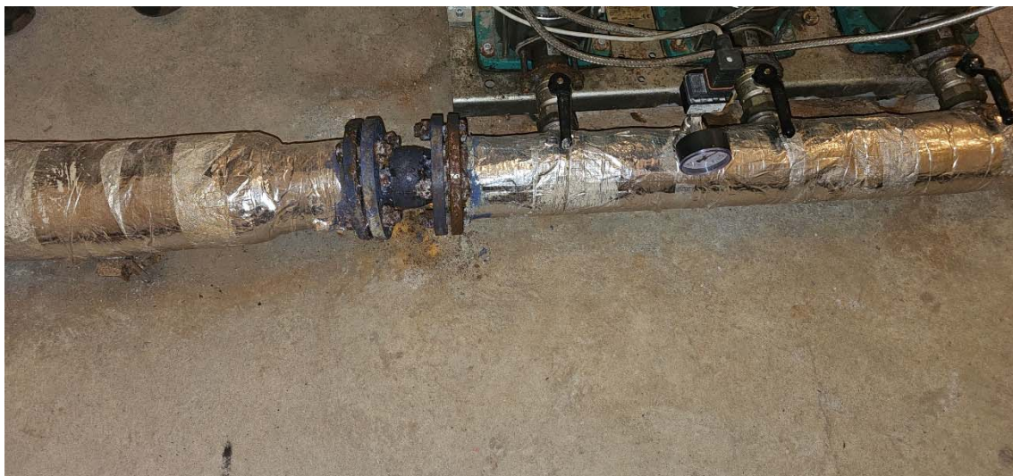
Фото 36 Значительная коррозия трубопроводов. Коррозия фланцевых соединений. Коррозия сварного соединения. Повреждение теплоизоляции трубопровода.
