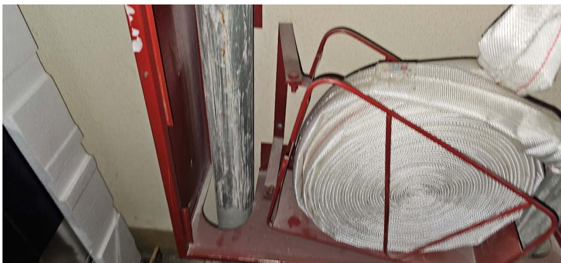
Фото 24 Поражение коррозией отдельных участков трубопроводов
