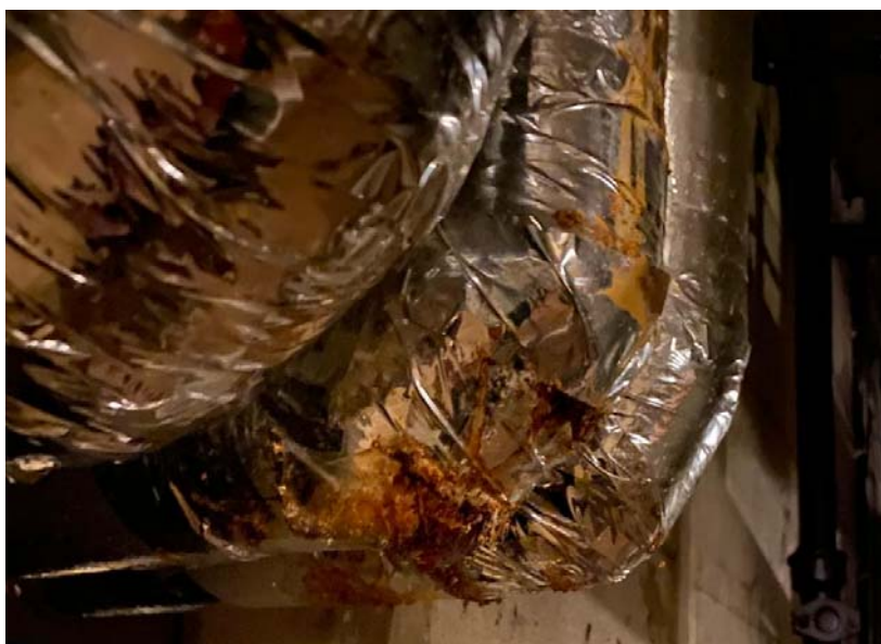
Фото 12 Значительная коррозия трубопроводов. Повреждение теплоизоляции трубопровода.
