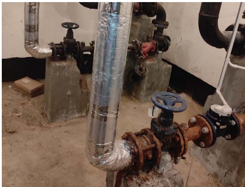
Фото 21 Значительная коррозия трубопроводов. Коррозия фланцевых соединений. Коррозия сварного соединения
