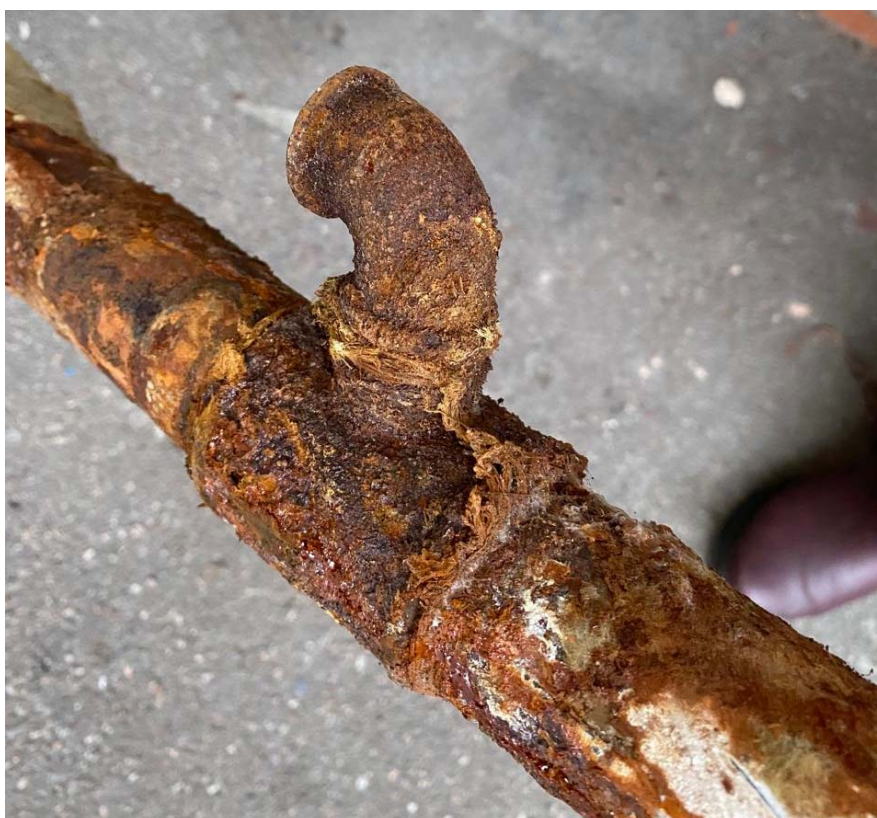
Фото 18 Значительная коррозия трубопроводов. Коррозия резьбового соединения. Коррозия сварного соединения
