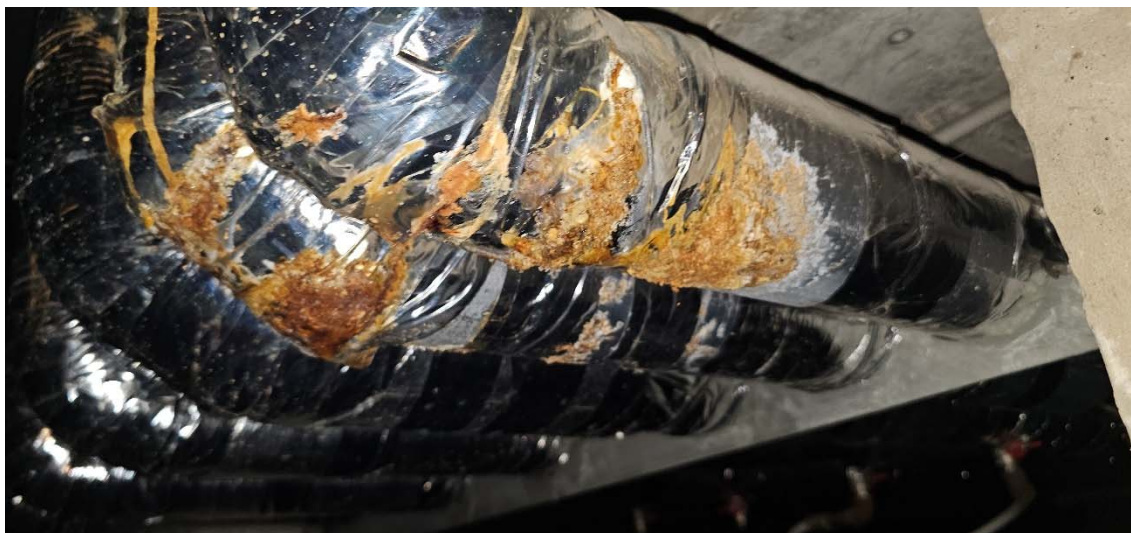
Фото 41 Повреждение теплоизоляции трубопровода.
