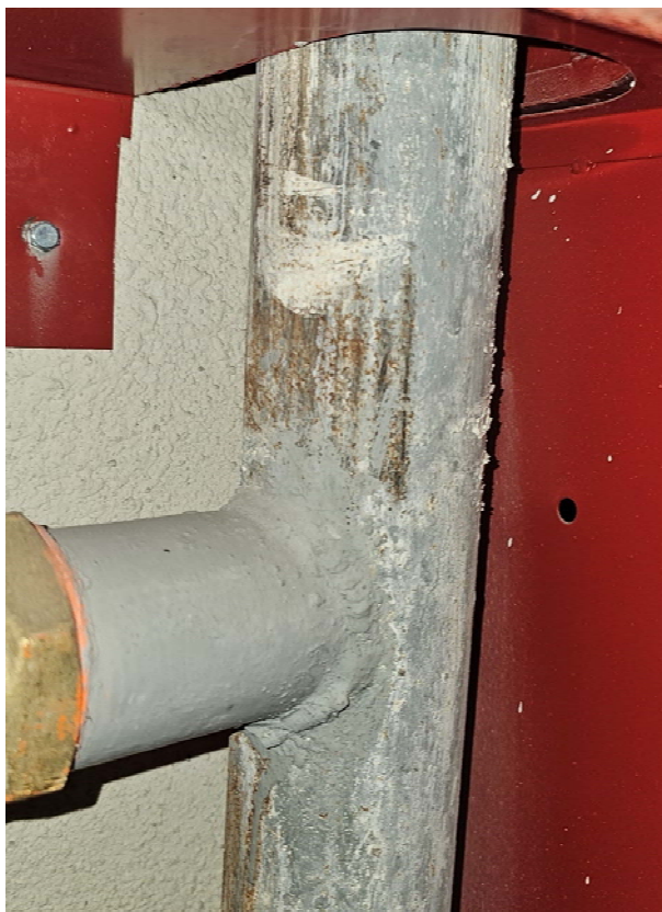
Фото 26 Поражение коррозией отдельных участков трубопроводов
