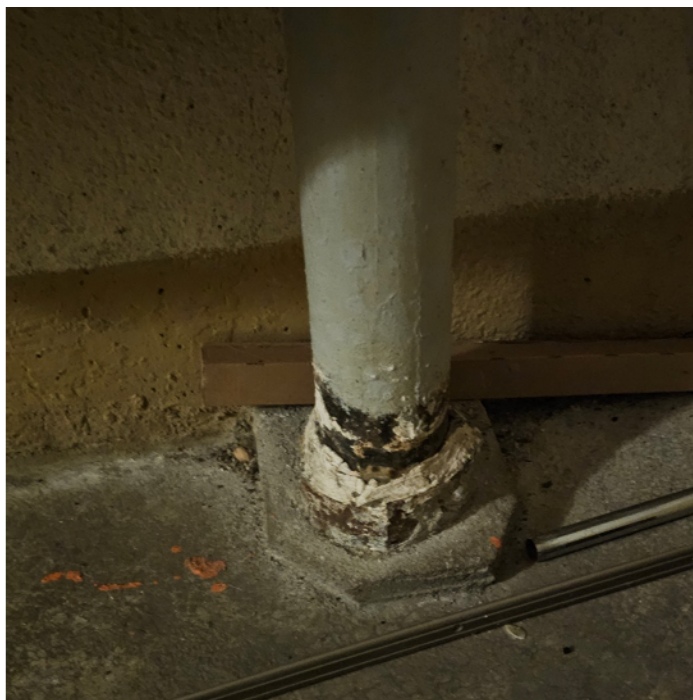
Фото 1 Поражение коррозией отдельных участков трубопроводов. Проходы через ограждающие конструкции не имеют металлические вставки (гильзы)
