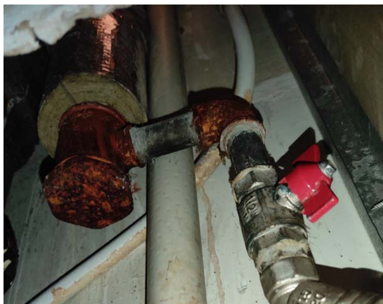
Фото 6 Значительная коррозия трубопроводов. Коррозия резьбового соединения.
