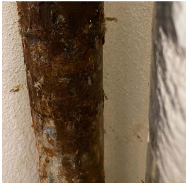
Фото 9 Значительная коррозия трубопроводов. Коррозия сварного соединения
