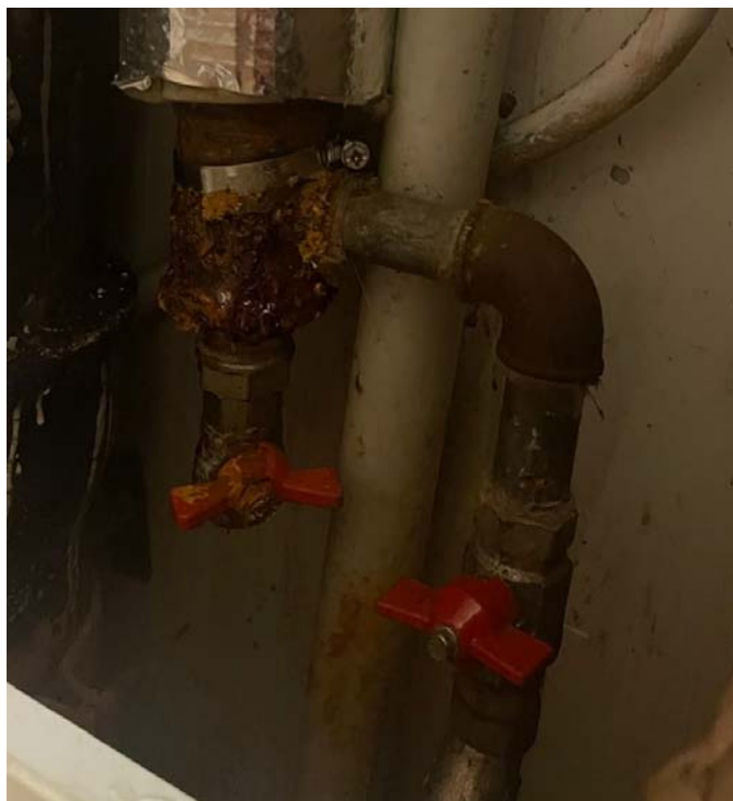
Фото 19 Значительная коррозия трубопроводов. Коррозия резьбового соединения. Коррозия сварного соединения
