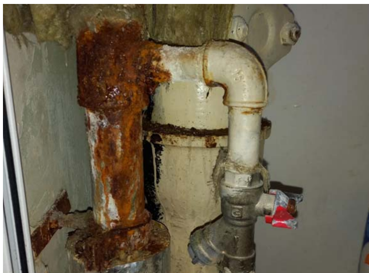
Фото 8 Значительная коррозия трубопроводов. Коррозия резьбового соединения. Коррозия сварного соединения Поражение коррозией отдельных участков трубопроводов
