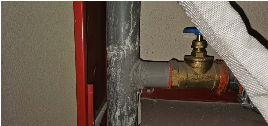
Фото 25 Поражение коррозией отдельных участков трубопроводов. Коррозия сварного соединения
