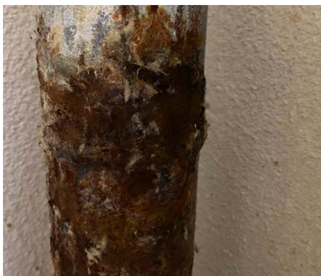
Фото 10 Значительная коррозия трубопроводов. Коррозия сварного соединения
