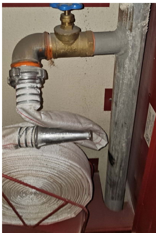
Фото 28 Поражение коррозией отдельных участков трубопроводов
