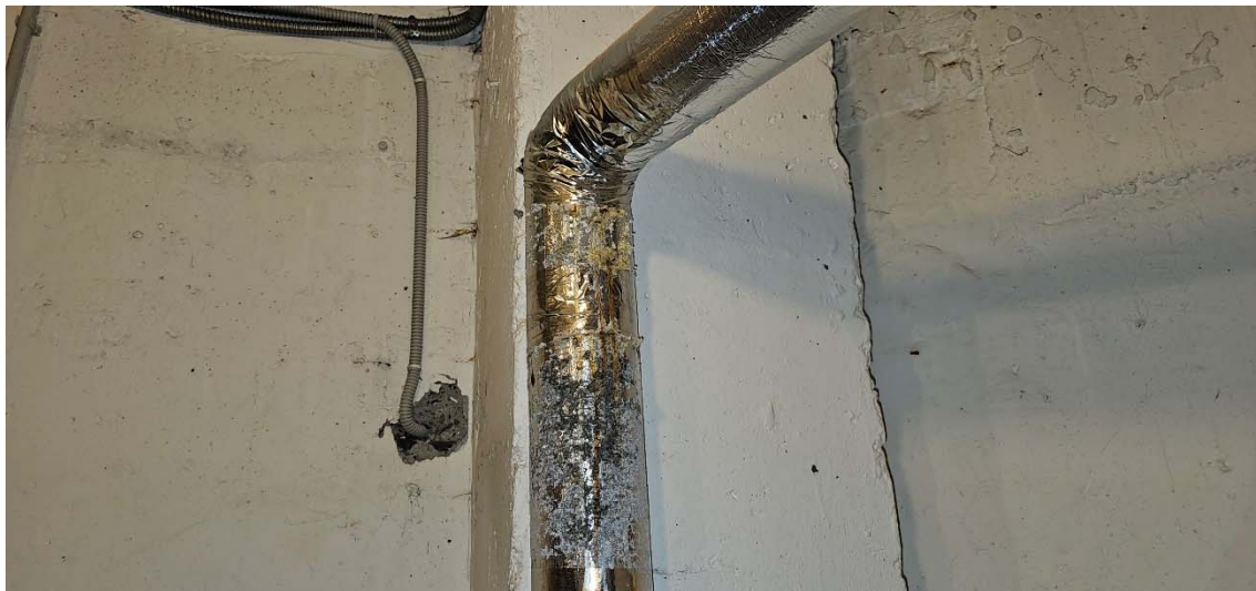
Фото 35 Повреждение теплоизоляции трубопровода.
